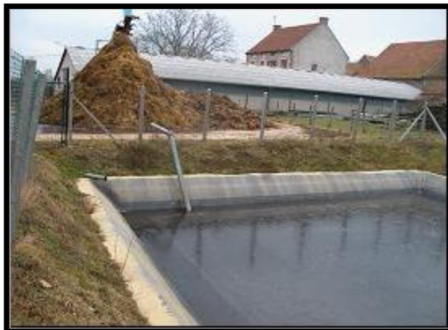
Plate-forme bétonnée pour le stockage de fumier avec fosse de récupération des jus
