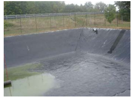
Point haut pour l'évacuation du trop-plein
