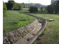
Les eaux de débordement rejoignent le réseau des eaux usées de la ville.
