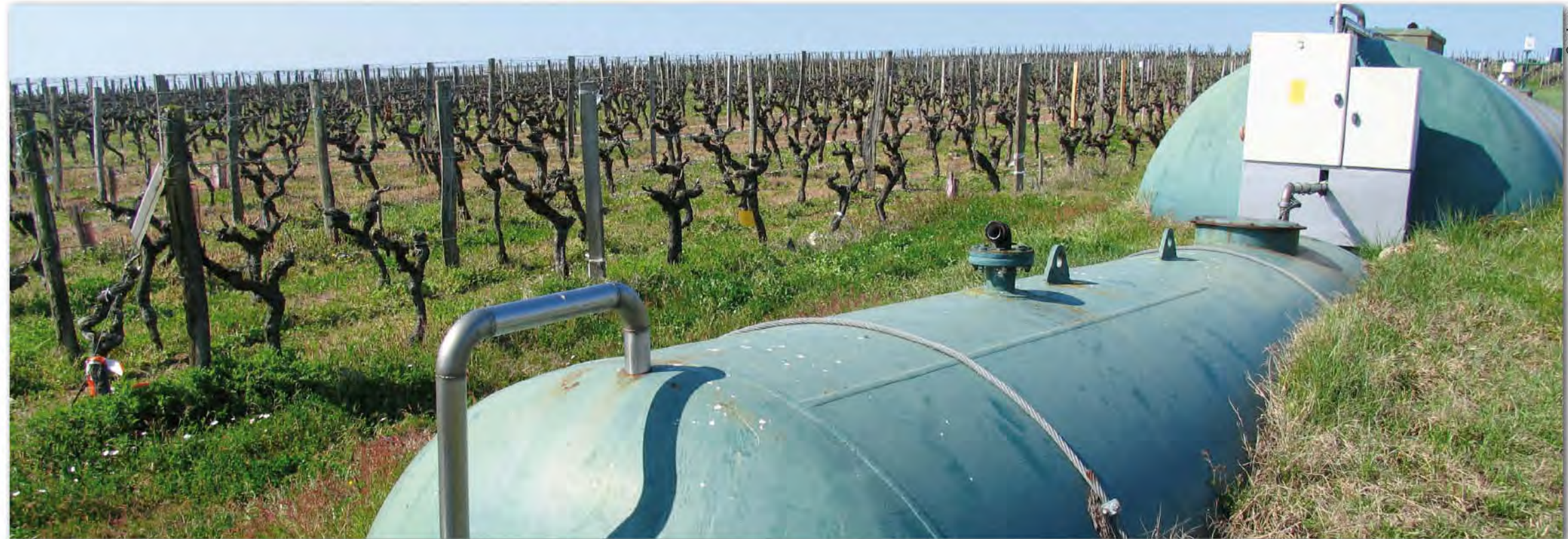
La station d'épuration vinicole sert à traiter les effluents du chai.
