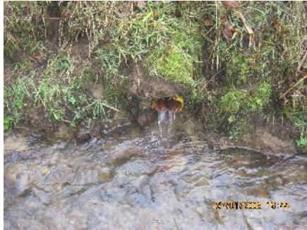
Sortie de drain
