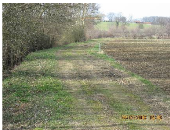
Tassement et dégradation
