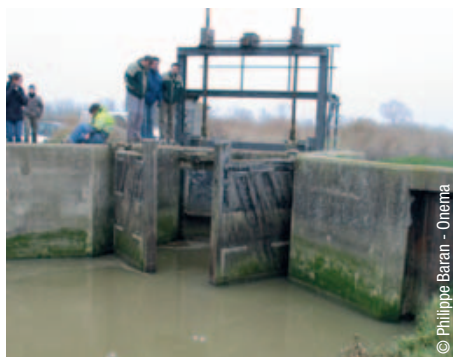
Portes à flot et vannage régulant les mouvements d'eau en estuaire.
