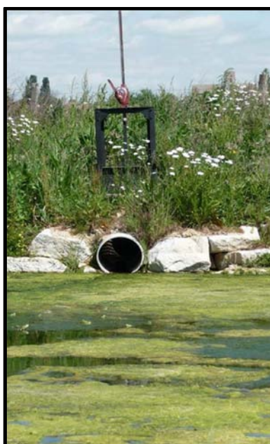
Figure 34 : Vanne d'alimentation de la ZTHA (bassin versant de Rampillon)
