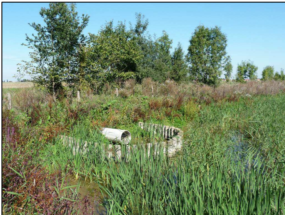
Figure 13 : Exutoire de la ZTHA végétalisée de Rampillon
