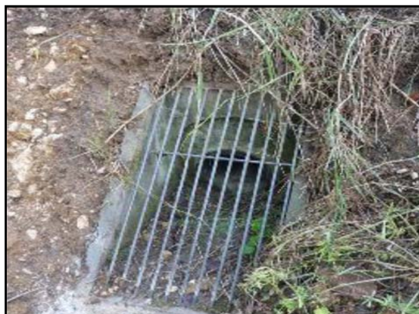
Figure 2 : Exutoire d'un collecteur de drainage
