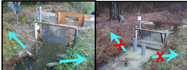
Figure 36 : Prises d'eau rustiques connectées à la ZTHA (site expérimental de Bray, Indre et Loire)
