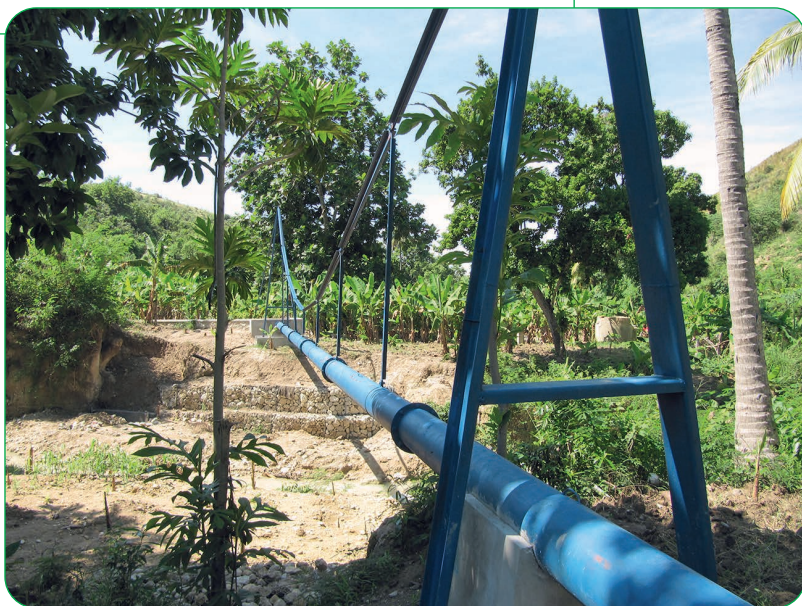
Photo 1.2. Franchissement d'une ravine par un aqueduc fabriqué localement dans les petits périmètres irrigués de la région de Saint-Marc, Haïti © Florence Deram Malerbe.
