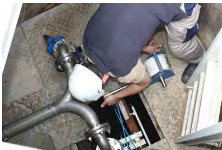
L'entreprise Veolia assure la maintenance du forage au pied du château d'eau de la Bergerie nationale.
