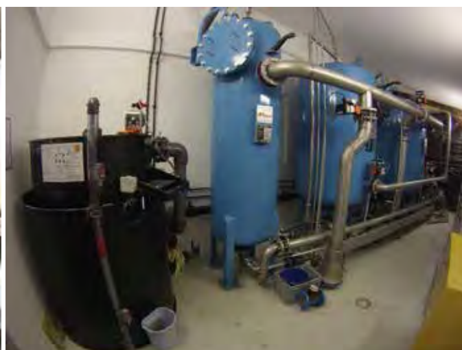
La station de traitement installée depuis 2012 à proximité du château d'eau.
