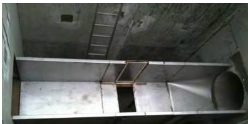
Figure 95 : Photo d'un piège à charriage à Marseille
