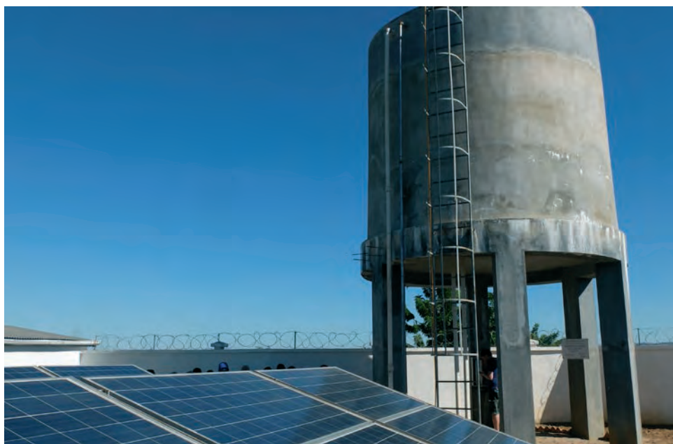
Château d'eau et pompage solaire à Madagascar
