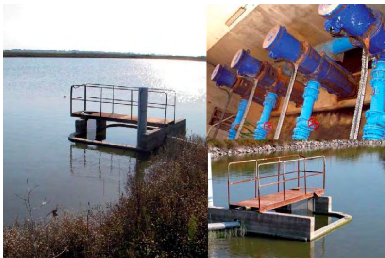
Vue du traitement tertiaire des eaux usées par lagunage et des pompes d'irrigation à Noirmoutier (installation exploitée par la Saur). SOURCE : Lazarova V., Brissaud F. (2007) Intérêt, bénéfices et contraintes de la réutilisation des eaux usées en France, Revue IEN l'eau, l'industrie, les nuisances. N° 299
