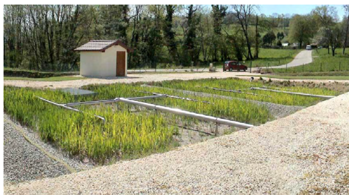
Figure 28 Filtre planté de roseaux
