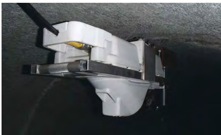
Figure 5. Débitmètre en entrée.
