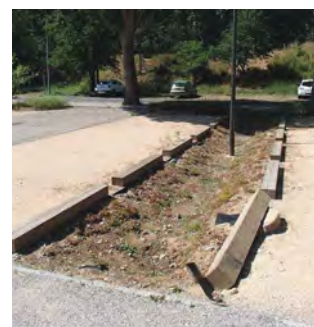
Figure 8. Basculement du madrier servant de butoir pour le parking
