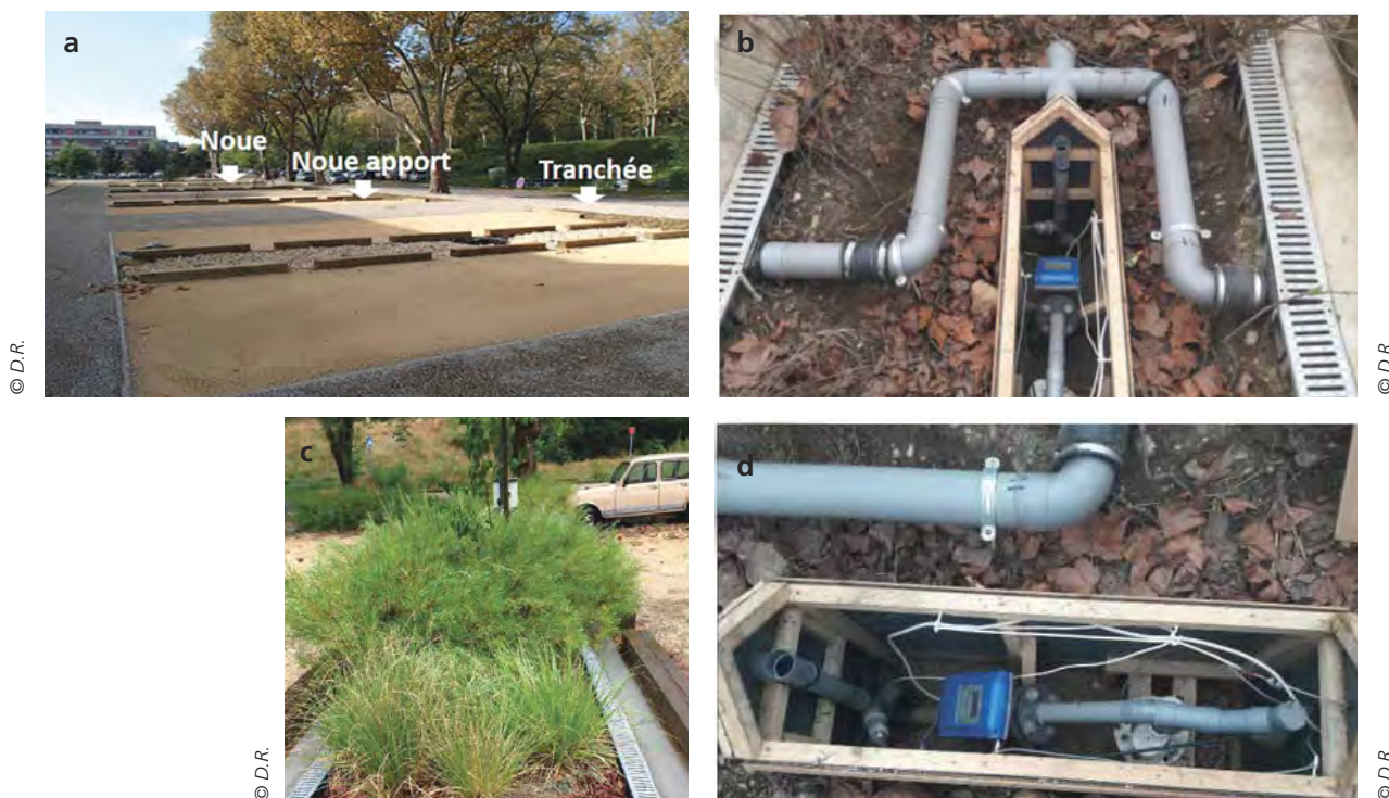
Figure 9. Système de mesure permettant d'évaluer les débits et volumes d'eau en entrée des systèmes drainés par la noue et la tranchée. a) montre la localisation et la similitude du site de référence, b) montre la noue de référence avec installation à la périphérie des caniveaux, c) et d) la connexion des caniveaux au système de mesure (double mesure 1/par auget basculant et 2/par mesure électromagnétique).
